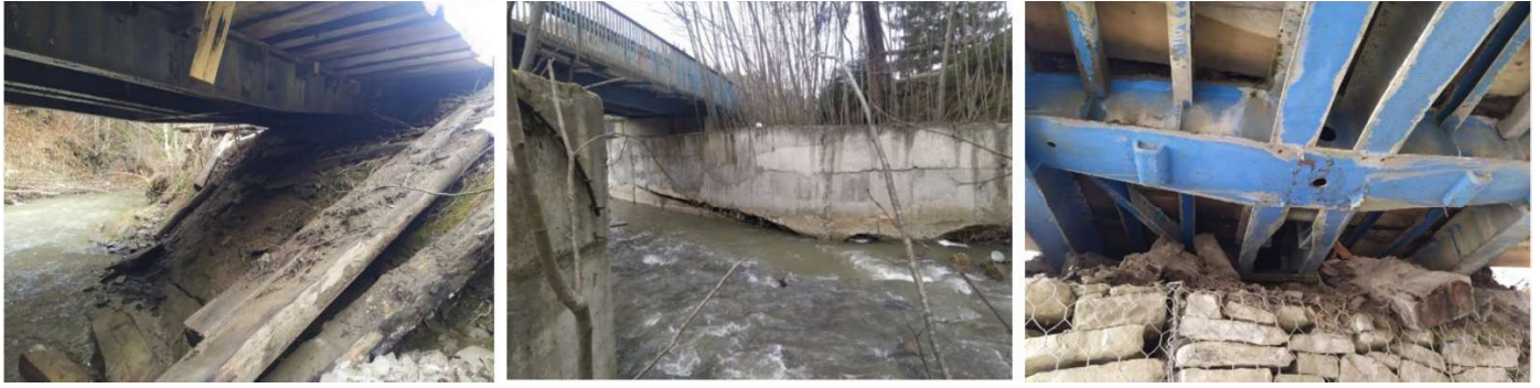
Рис. 9 Аварійний стан мостів в зоні дороги Т-26-01
